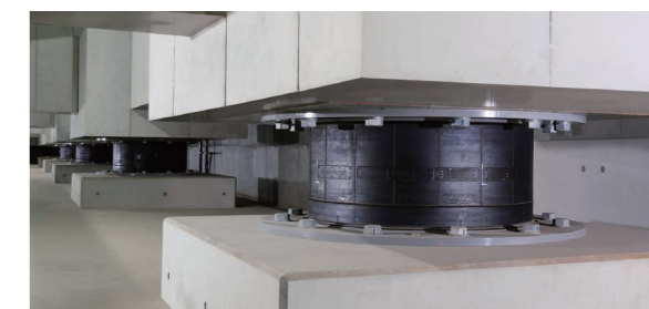
免震構造マンションの免震装置
