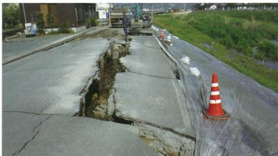
①地割れで通行不能となった道路
