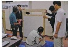
施工研修では、実際に使用する耐震建材を用いて、施工や補修のために必要な技術を学んでいる
